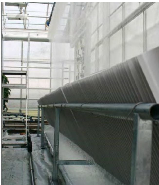
Bilde 3: Bildet viser et eksempel på vanngardin. Et tett slør av vann forhindrer forurensningen i å vandre. Partiklene blir fanget av vannet og dratt ned i en renne og fraktet ut.
